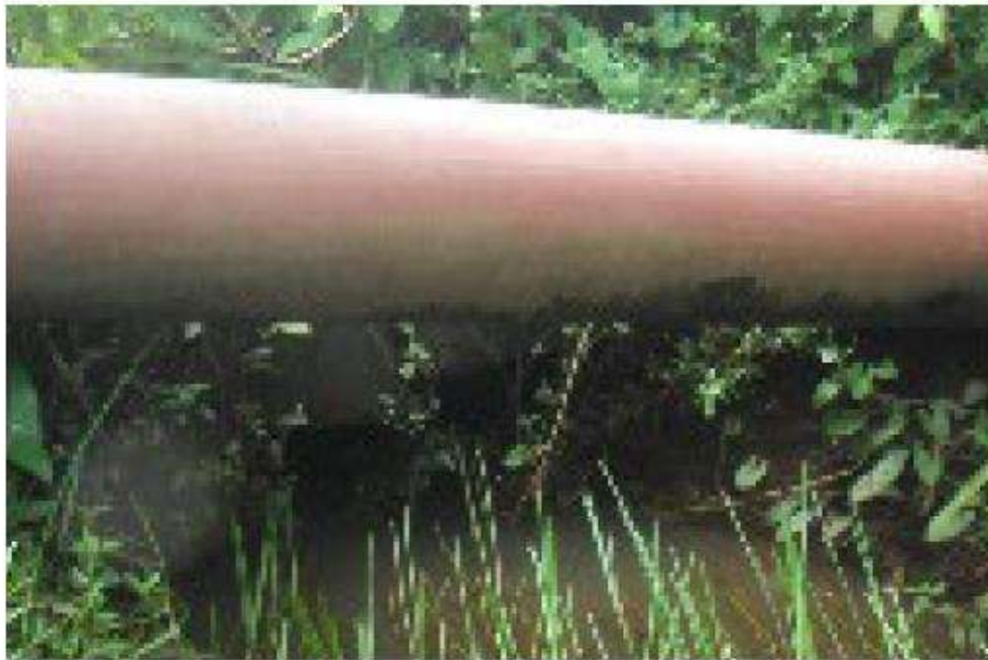
Ouvrage type buse sous-dimensionnée, Soula 1 aval talweg D. Photo issue de l'étude d'impact AGIR, mars 2018
