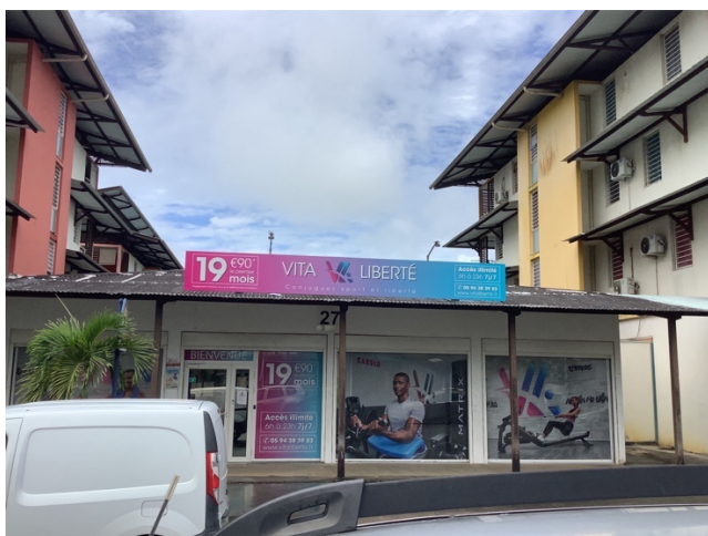
Enseigne sur toiture avec un panneau plein (illégal)
